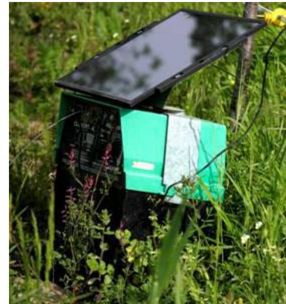
Alimentatore della recinzione elettrificata ricaricato da un pannello solare (per ridurre i tempi e costi della manutenzione)
